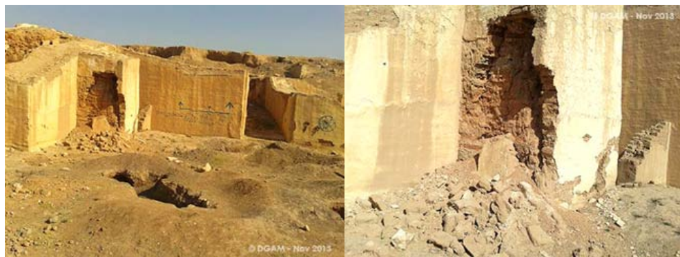
Fig. 5 a-b: Ebla. Mura del palazzo reale danneggiate da scavi clandestini (novembre 2013).
