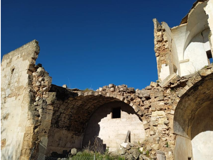
fig. 4 - Abitazione diruta. Sono visibili il riempimento di muraglie e volta, e in alto una mpisa residua
